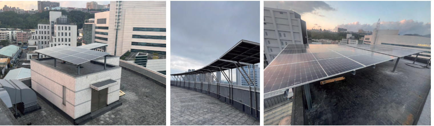
▲台北捐血中心 2025 年於愛心樓頂樓完成太陽能光電裝置
